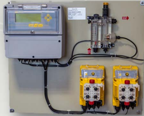
Helios 05 con 2 bombas
